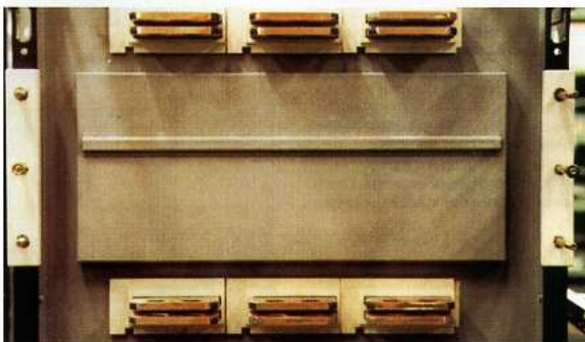
Figura 4.- Protección contra arcos eléctricos. Compartimentado del embarrado general.
